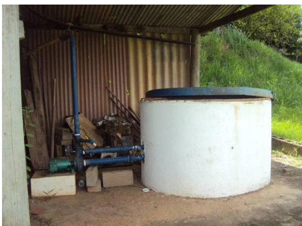
Figura 3.2.65. Vista do Poço Semi-Profundo 03
