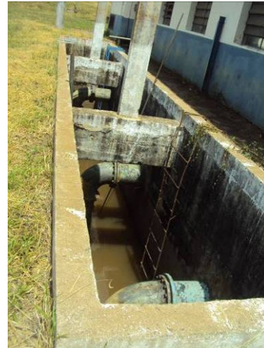
Figura 3.2.22. Vista do Poço de Sucção – Casa de Bombas nº. 02
