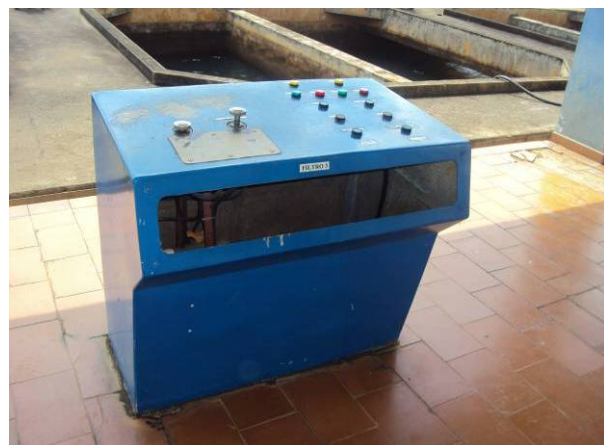
Figura 3.2.43. Vista do painel do filtro
