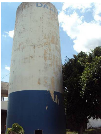
Figura 3.2.50. Vista do Reservatório elevado na ETA II
