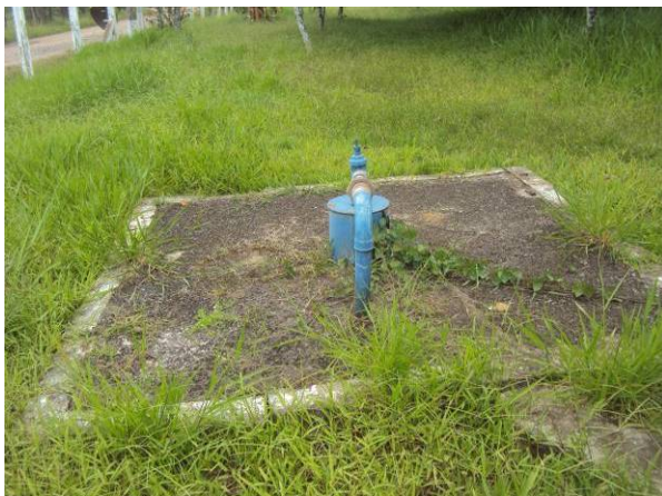
Figura 3.2.63. Vista do Poço Profundo 02
