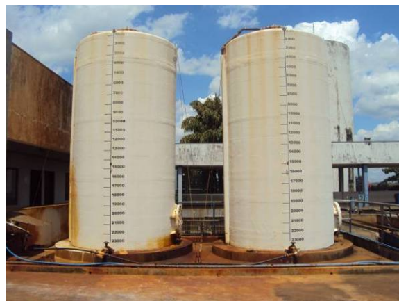
Figura 3.2.45. Vista dos reservatório de Cloreto Férrico e Ácido Fluorsilícico
