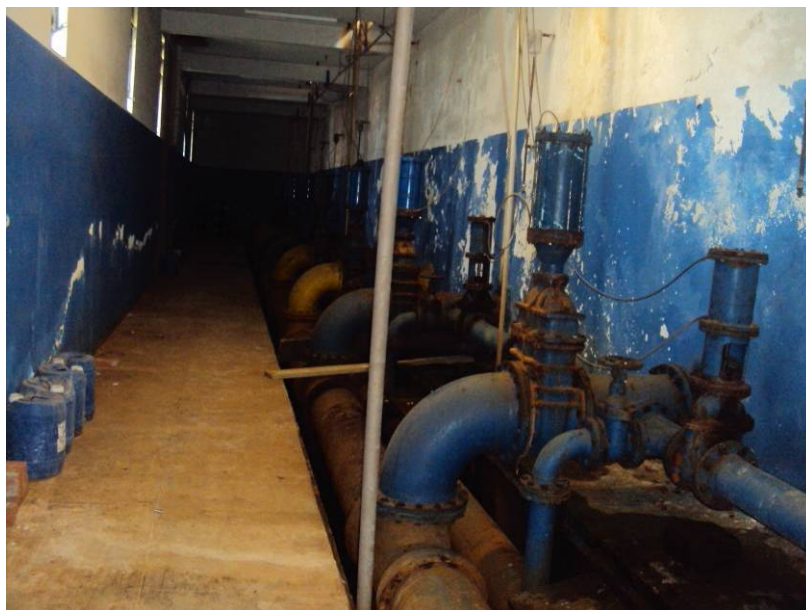
Figura 3.2.38. Vista dos Conjuntos Motor-Bomba – Casa de Bombas nº. 02
