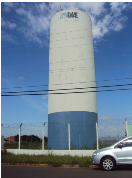
Figura 3.2.98. Vista do Reservatório Jardim Novo (Elevado)
