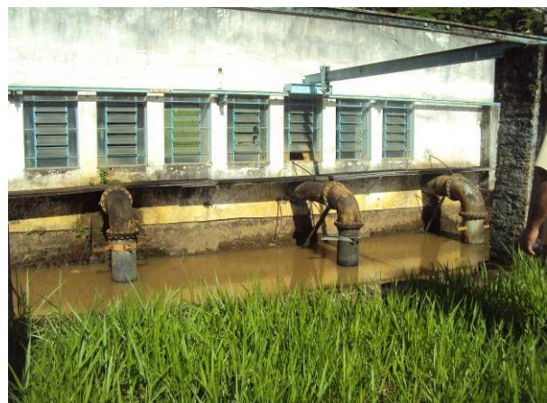
Figura 3.2.14. Vista do Poço de sucção (Casa de bombas 02)
