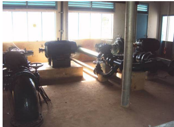
Figura 3.2.12. Vista dos conjuntos motor-bomba (Casa de bombas 01)
