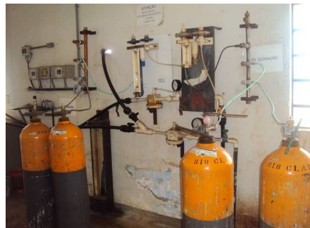
Figura 3.2.31. Vista dos Cilindros de Gás Cloro para a pré e pós cloração
