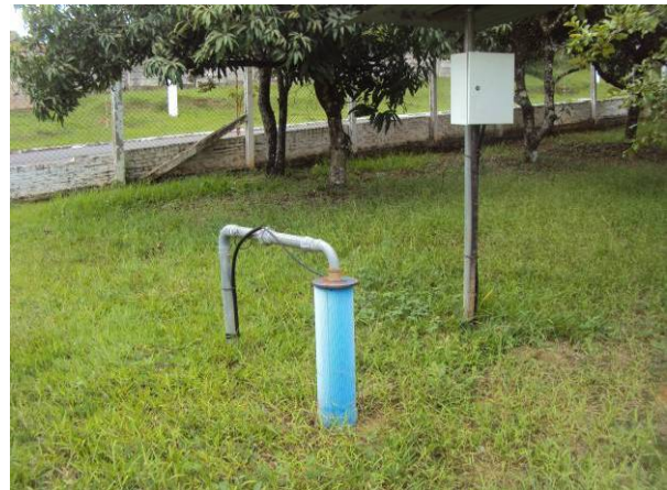
Figura 3.2.62. Vista do Poço Profundo 01 e painel elétrico
