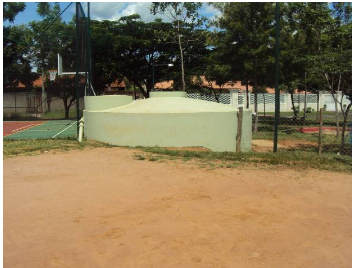
Figura 3.2.106. Vista do Reservatório Residencial Florença (Semi-Enterrado)
