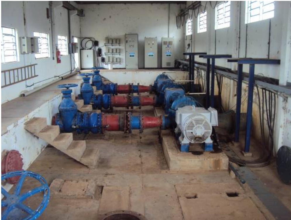
Figura 3.2.23. Vista dos conjuntos motor-bomba e painéis elétricos – Casa de bombas nº. 02
