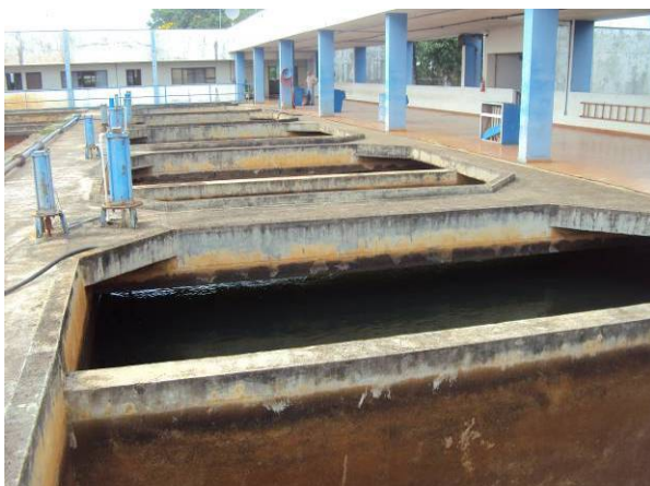
Figura 3.2.42. Vista dos Filtros
