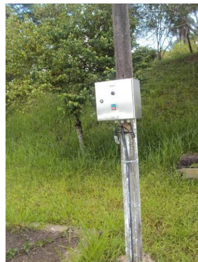
Figura 3.2.64. Vista do Painel elétrico do Poço Profundo 02
