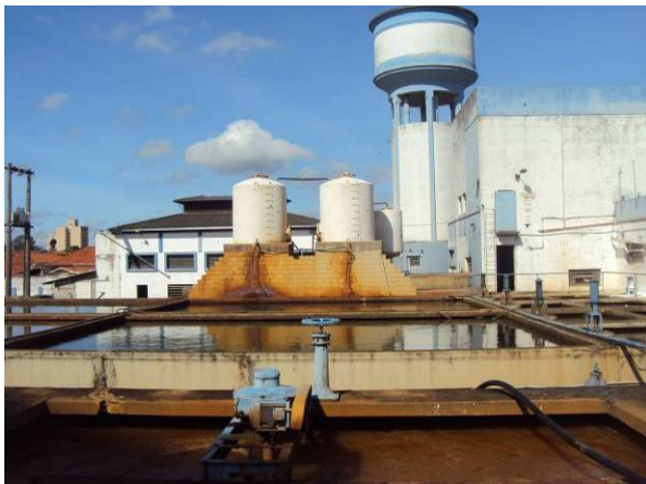
Figura 3.2.28. Vista dos decantadores
