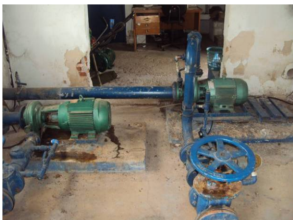
Figura 3.2.67. Vista dos Conjuntos Motor-Bomba
