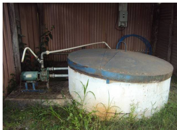
Figura 3.2.66. Vista do Poço Semi-Profundo 04
