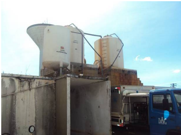
Figura 3.2.32. Vista dos reservatórios de Ácido Fluorsilício
