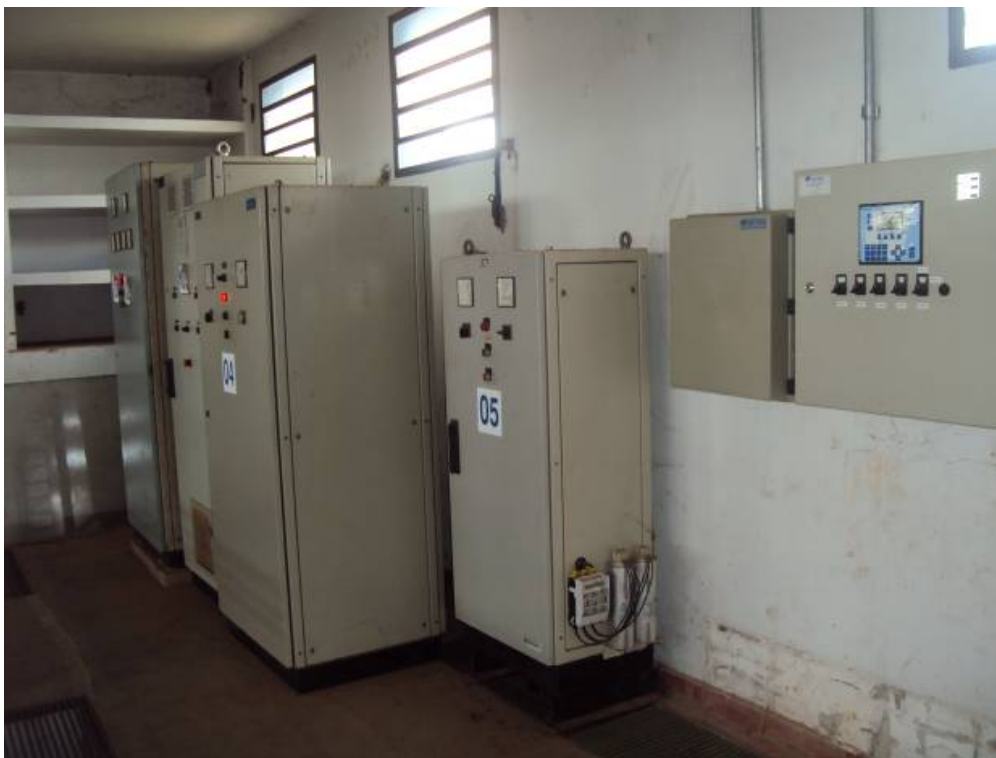
Figura 3.2.54. Vista dos painéis elétricos – Casa de Bomba n.º. 02
