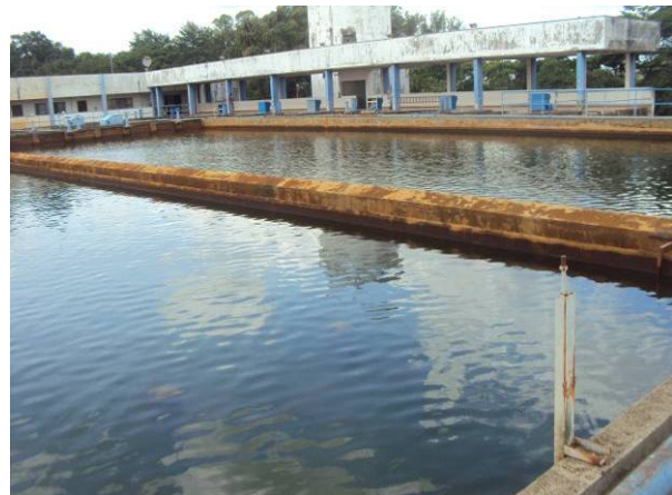
Figura 3.2.41. Vista dos decantadores
