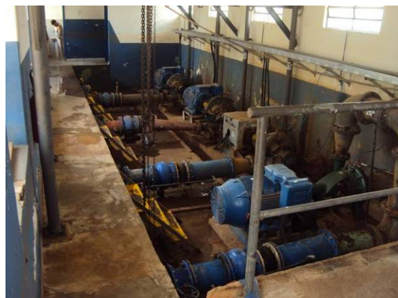
Figura 3.2.20. Visto dos conjuntos motor-bomba – Casa de Bombas n.º. 01
