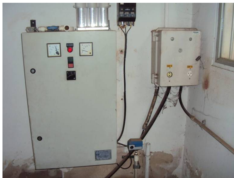
Figura 3.2.5. Vista do Painel Elétrico
