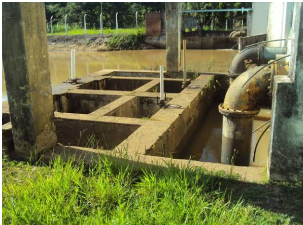
Figura 3.2.11. Vista do Poço de sucção (Casa de bombas 01)
