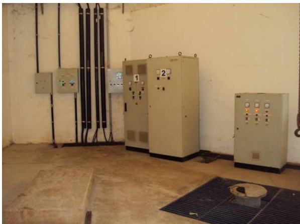
Figura 3.2.57. Vista dos Painéis Elétricos da Casa de Bomba da Central de Distribuição
