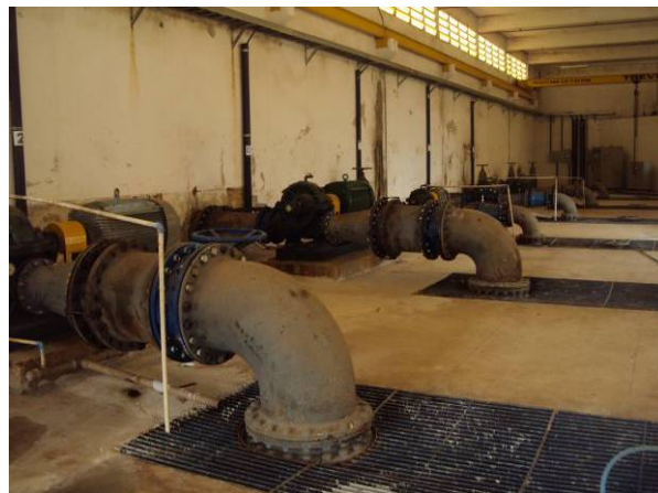
Figura 3.2.56. Vista dos conjuntos motor-bomba da Casa de Bomba da Central de Distribuição
