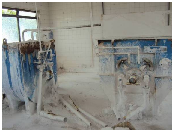
Figura 3.2.47. Vista do misturador de Cal
