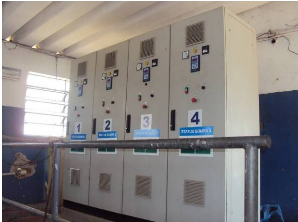
Figura 3.2.21. Vista do painel elétrico – Casa de Bombas nº. 01
