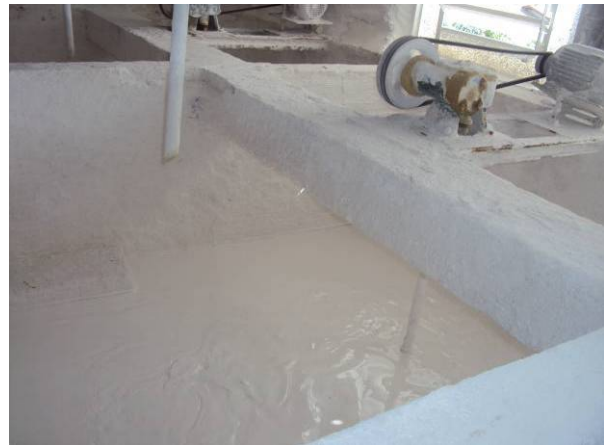
Figura 3.2.33. Vista do Misturador de Cal
