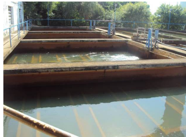
Figura 3.2.29. Vista dos Filtros
