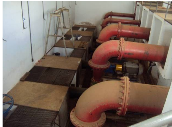
Figura 3.2.53. Vista da Casa de bomba n.º. 02
