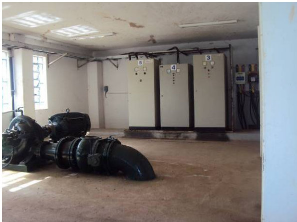
Figura 3.2.15. Vista de um conjunto motor-bomba e dos painéis elétricos da casa de bombas 02
