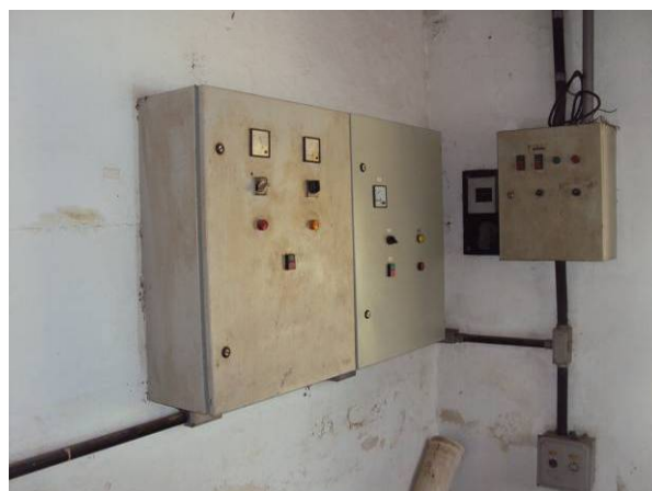
Figura 3.2.68. Vista do Painel Elétrico da Casa de bombas
