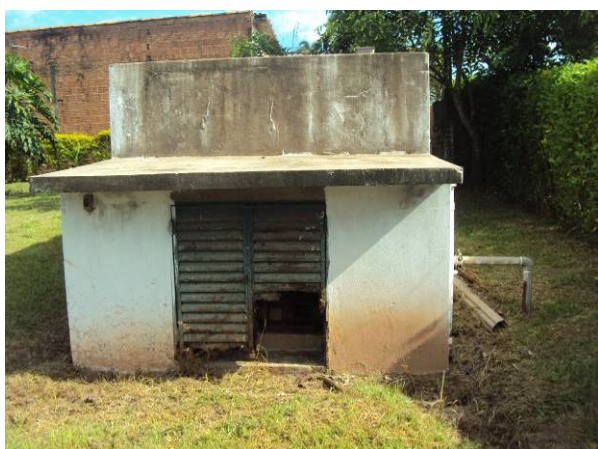
Figura 3.2.80. Vista do Booster que recalca água do Reservatório 01 para o reservatório 02
