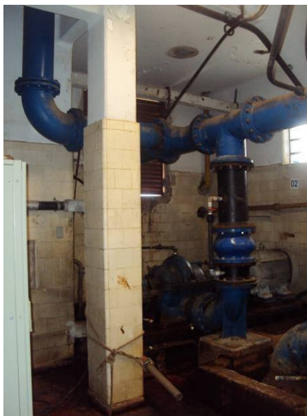
Figura 3.2.37. Vista do Conjunto motor-bomba situado na Casa de Bombas nº 01
