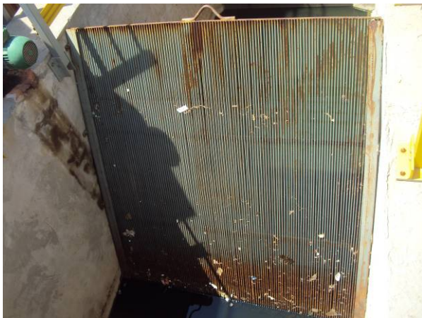
Figura 3.3.67. Vista do gradeamento
