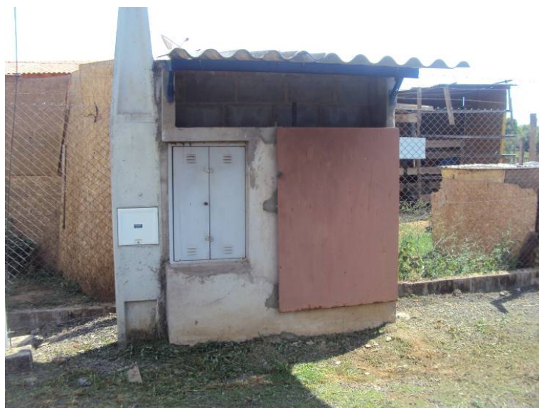
Figura 3.3.52. Vista do painel elétrico
