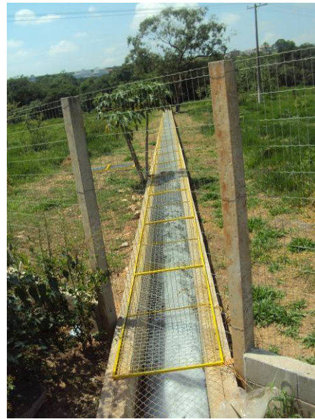
Figura 3.3.78. Vista do efluente tratado, encaminhamento até o Ribeirão
