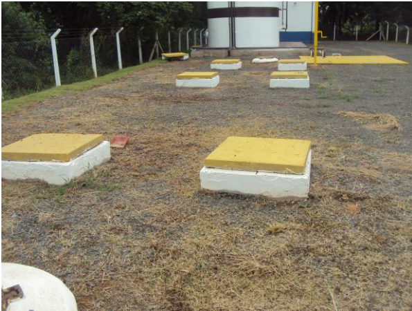
Figura 3.3.121. Vista da Fossa Séptica
