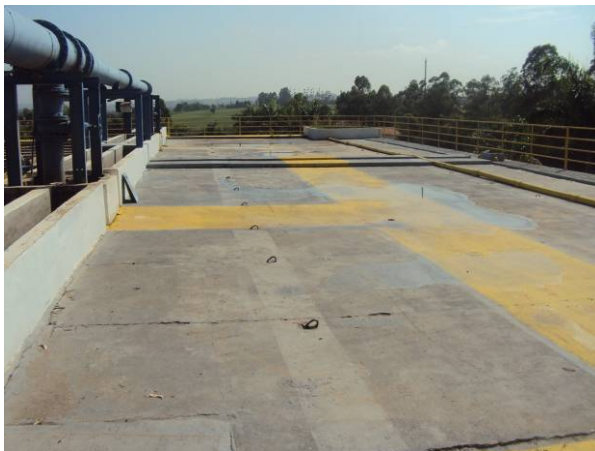
Figura 3.3.25. Vista dos Reatores UASB
