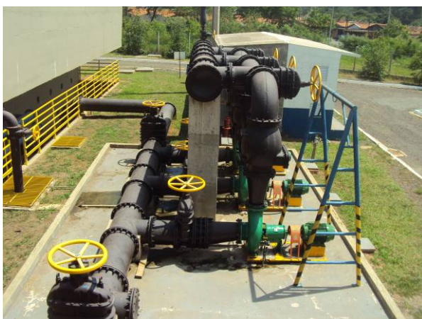
Figura 3.3.75. Vista dos conjuntos motor-bomba do reciclo de Lodo
