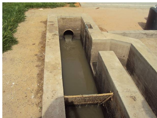
Figura 3.3.96. Vista da chegada do esgoto e gradeamento
