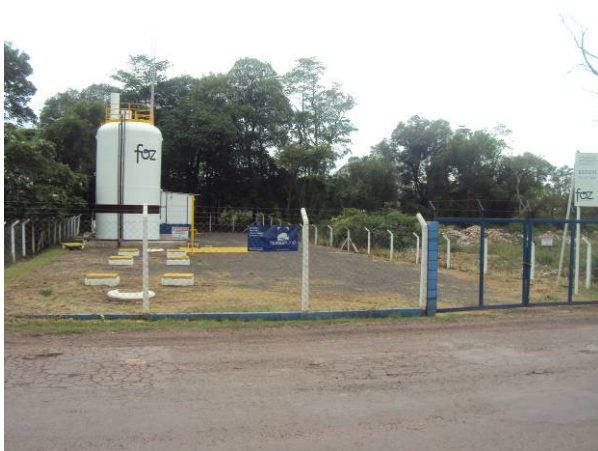
Figura 3.3.119. Vista da ETE
