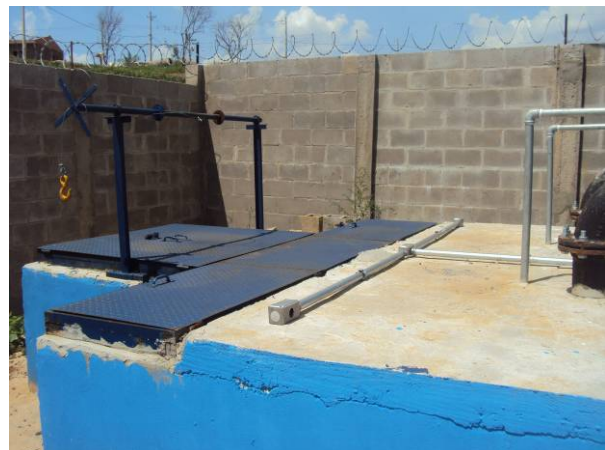
Figura 3.3.39. Vista do Poço de Sucção e Gradeamento
