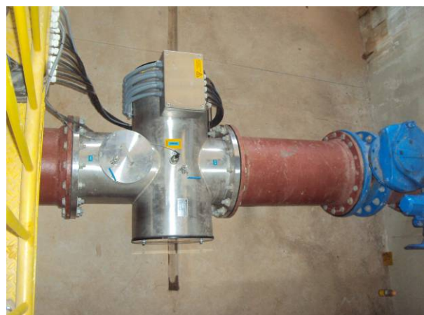
Figura 3.3.76. Vista do equipamento de Ultra-Violeta
