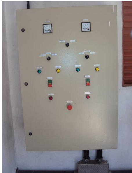
Figura 3.3.42. Vista do painel elétrico
