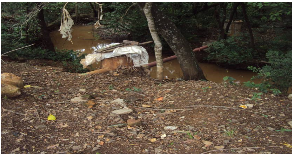
Figura 3.3.17. Vista da tubulação que encaminha o efluente tratado para lançamento
