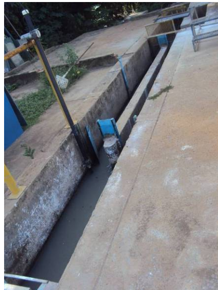
Figura 3.3.17. Vista da Caixa de Areia
