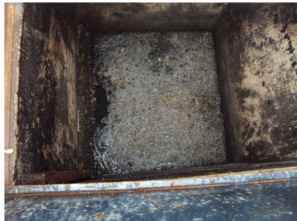
Figura 3.3.114. Vista da Caixa de chegada e gradeamento
