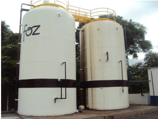
Figura 3.3.125. Vista reator UASB e Filtro Aeróbio Submerso
