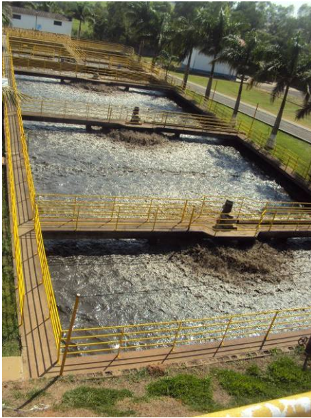
Figura 3.3.27. Vista dos Tanques de Aeração
