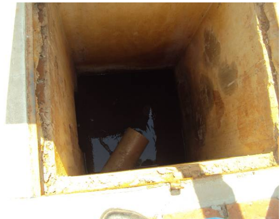
Figura 3.3.35. Vista da Chegada do esgoto na EEE
