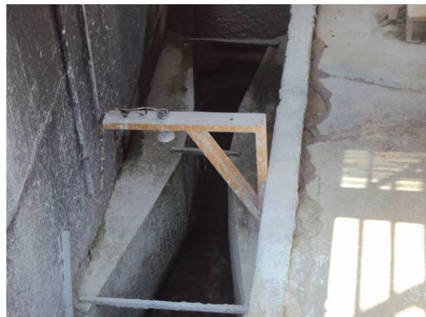
Figura 3.3.61. Vista da Calha Parshall na EEE
