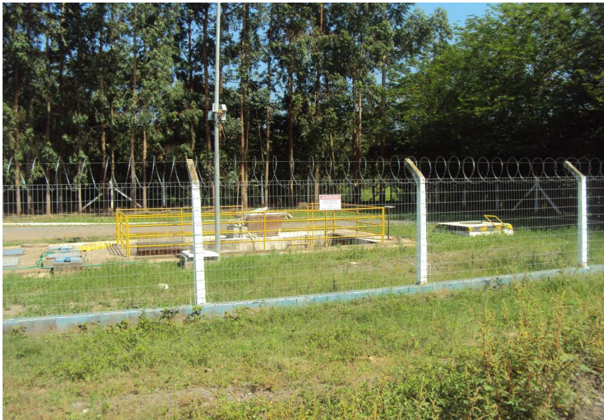
Figura 3.3.56. Vista do gradeamento, caixa de areia e poço de sucção
