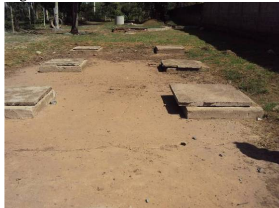
Figura 3.3.134. Vista do tratamento: Fossa Séptica
