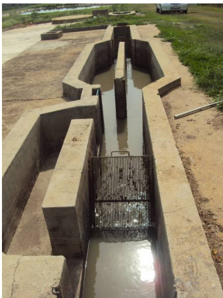
Figura 3.3.97. Vista do gradeamento e caixa de areia
