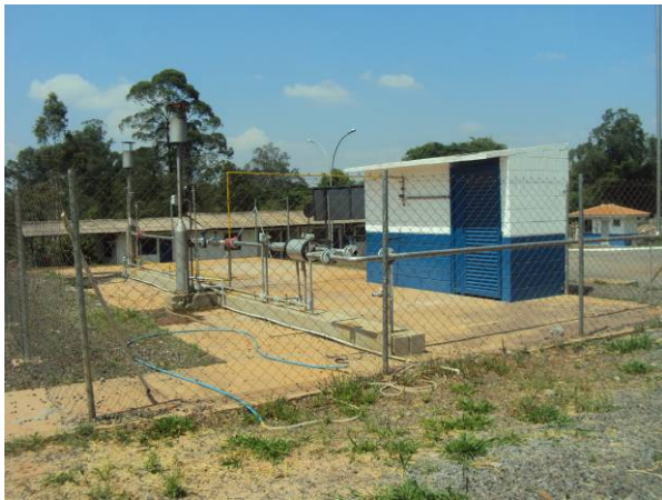
Figura 3.3.71. Vista do Filtro de Gás
