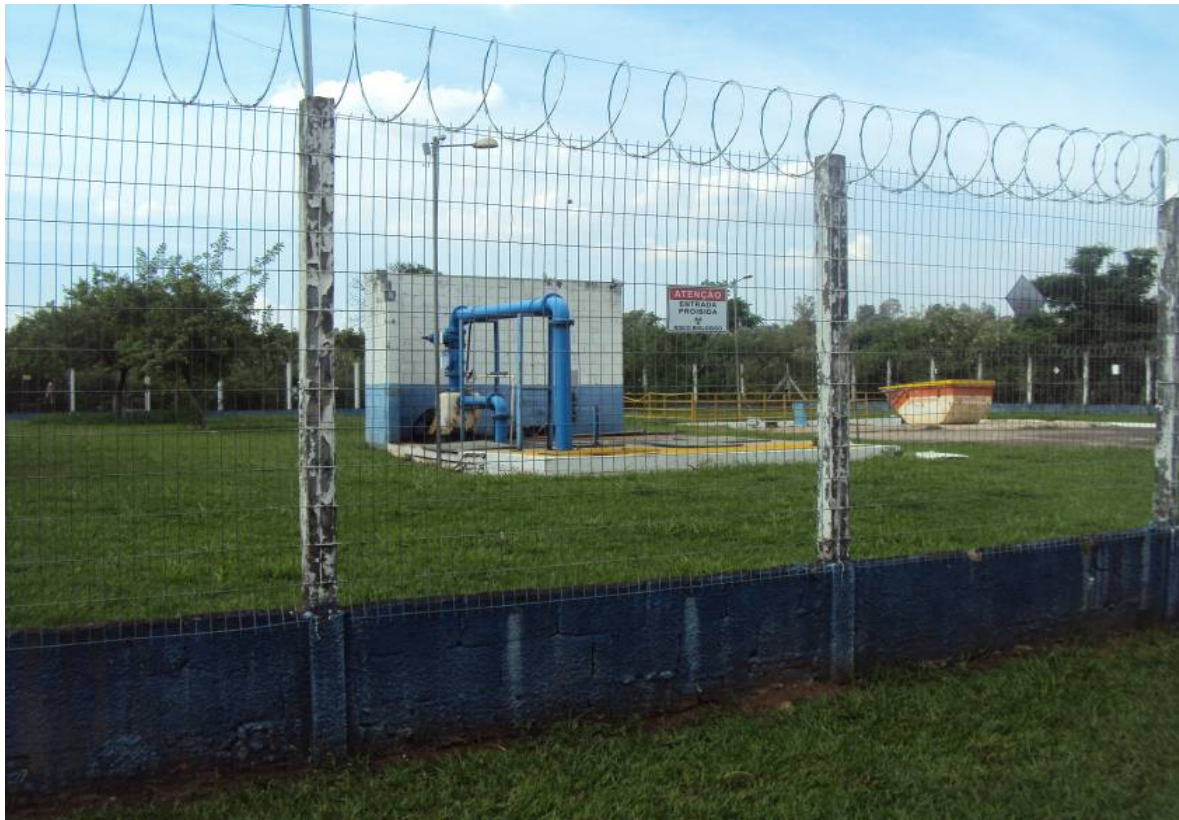
Figura 3.3.88. Vista do Gradeamento e Poço de Sucção
