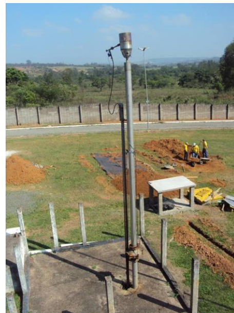
Figura 3.3.26. Vista do Queimador de gás
