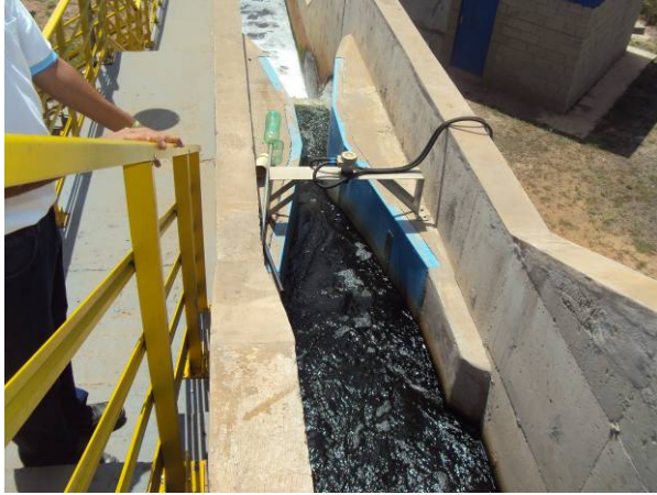
Figura 3.3.77. Vista da calha parshall na saída do efluente tratado
