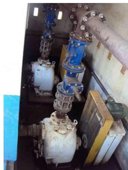
Figura 3.3.21. Vista dos Conjuntos Motor-Bomba
