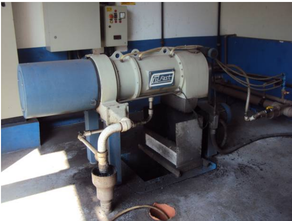
Figura 3.3.29. Vista da centrífuga de Lodo
