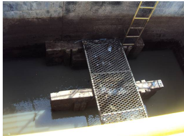
Figura 3.3.59. Vista da Chegada do esgoto na EEE
