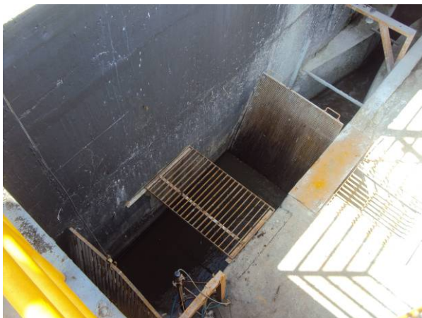
Figura 3.3.60. Vista do Gradeamento na EEE
