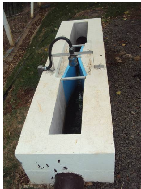
Figura 3.3.128. Vista da calha parshall na saída do tratamento
