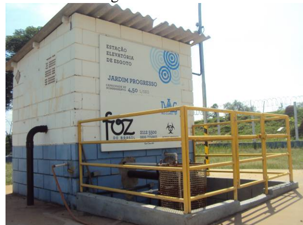
Figura 3.3.45. Vista da placa informativa da EEE e poço de sucção
