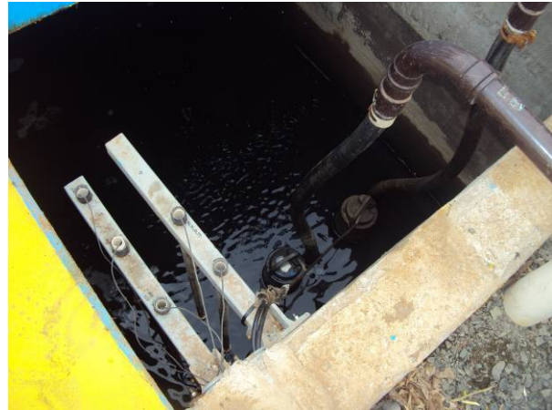
Figura 3.3.122. Vista do Poço de sucção e bombas
