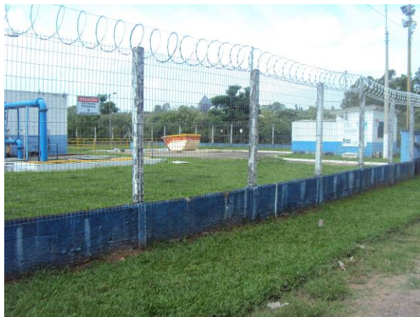
Figura 3.3.86. Vista da EEE Vila Industrial
