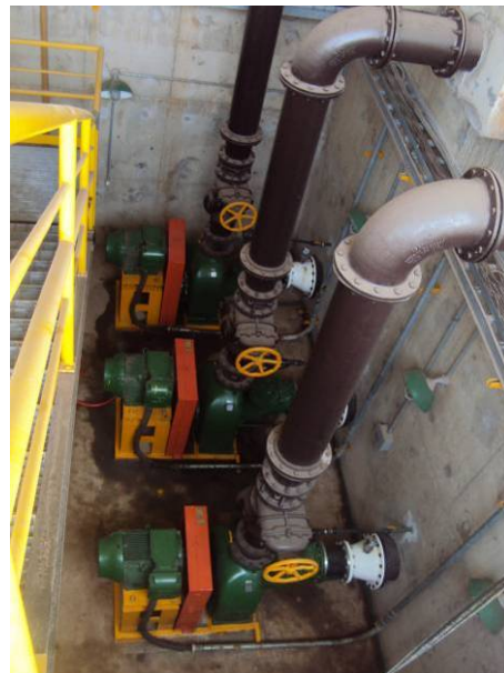
Figura 3.3.93. Vista dos conjuntos motor-bomba que recalcam para o início do tratamento
