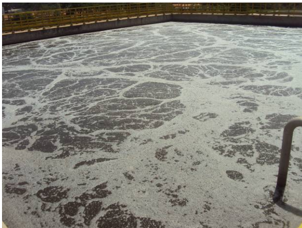
Figura 3.3.73. Vista do Tanque de Aeração
