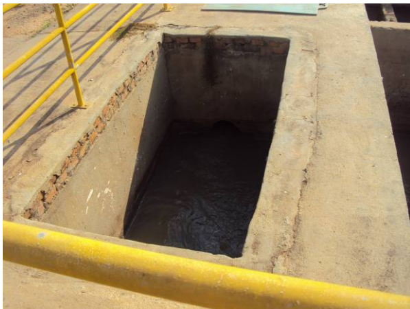
Figura 3.3.18. Vista do Gradeamento
