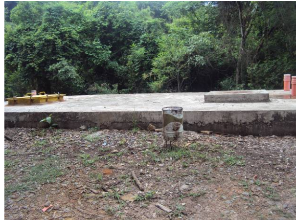
Figura 3.3.108. Vista da Fossa Filtro
