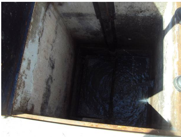
Figura 3.3.50. Vista da chegada do esgoto e gradeamento
