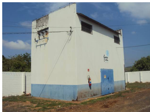
Figura 3.3.63. Vista da casa de energia
