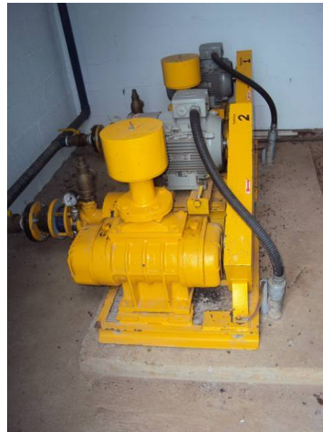
Figura 3.3.126. Vista do conjunto motor-bomba soprador
