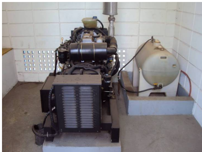
Figura 3.3.84. Vista do gerador de energia
