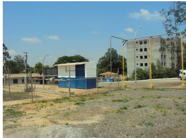
Figura 3.3.72. Vista da Tubulação de gás, e do queimador de gás
