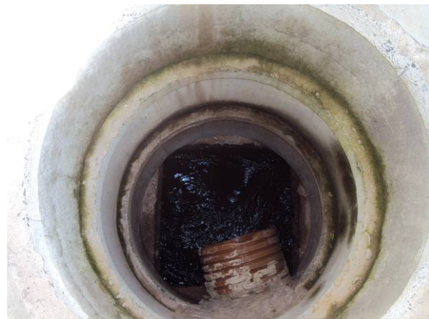
Figura 3.3.32. Vista interna do PV aonde são coletadas amostras do Efluente Final
