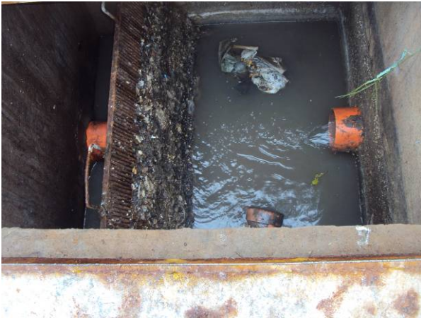
Figura 3.3.107. Vista do gradeamento
