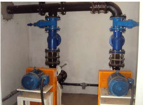
Figura 3.3.40. Vista do Conjunto Motor-Bomba
