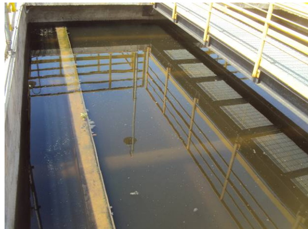
Figura 3.3.74. Vista do Tanque Decantador
