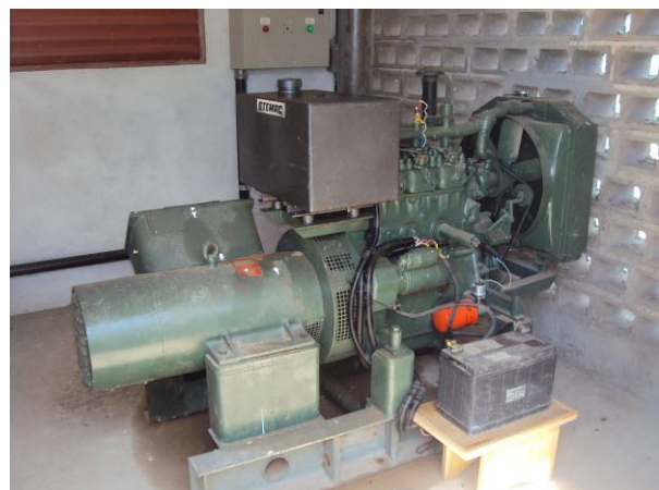
Figura 3.3.41. Vista do Gerador de Energia
