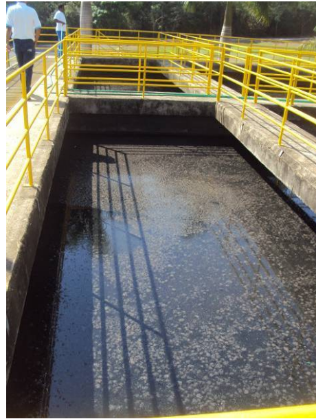
Figura 3.3.28. Vista dos Tanques de Decantação
