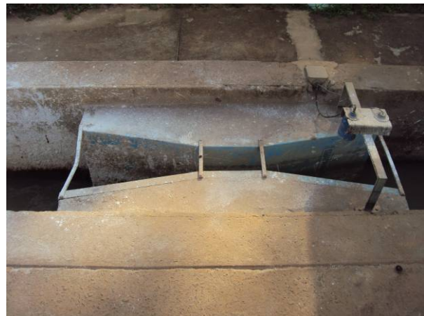
Figura 3.3.19. Vista da Calha Parshall
