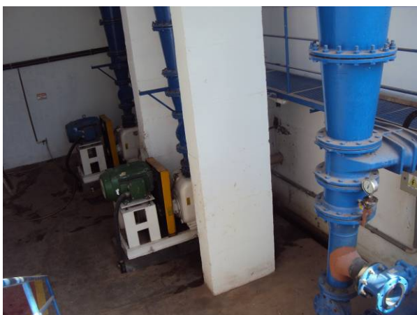
Figura 3.3.62. Vista dos Conjuntos Motor-Bomba
