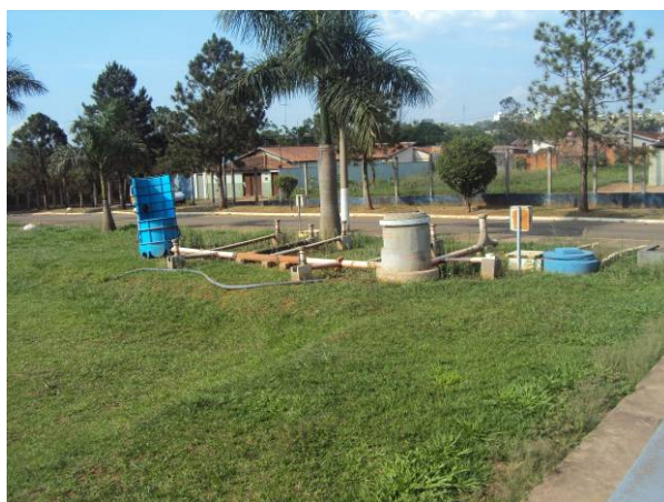
Figura 3.3.11. Coletor e queimador de gases
