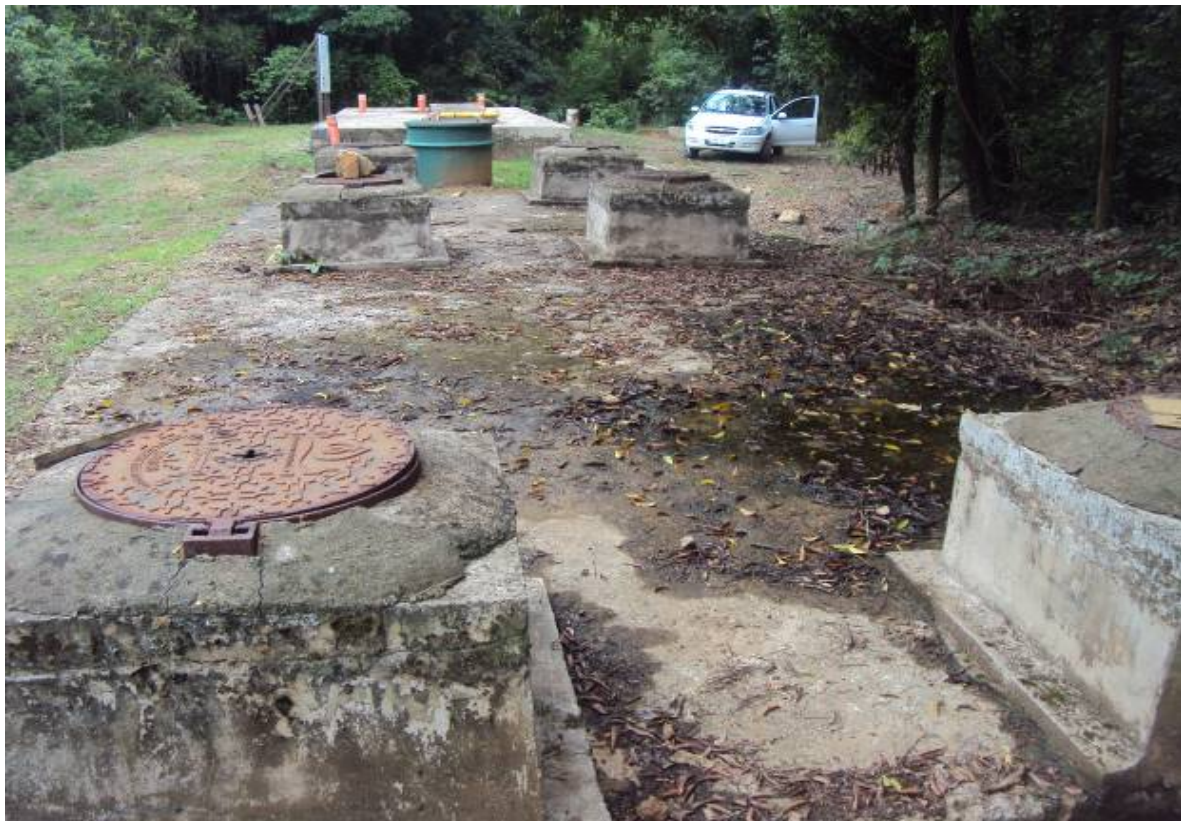
Figura 3.3.109. Vista do Filtro Anaeróbio
