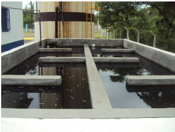
Figura 3.3.127. Vista do tanque de contato
