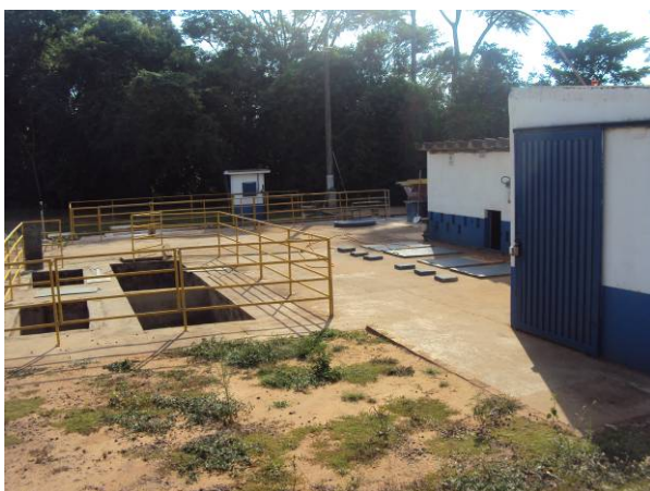
Figura 3.3.20. Vista do Poço de sucção
