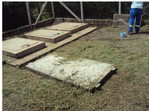
Figura 3.3.51. Vista do Poço de Sucção
