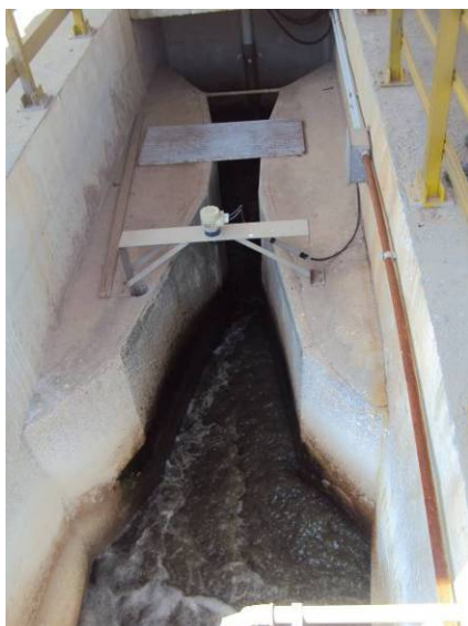
Figura 3.3.69. Vista da Calha Parshall na entrada
